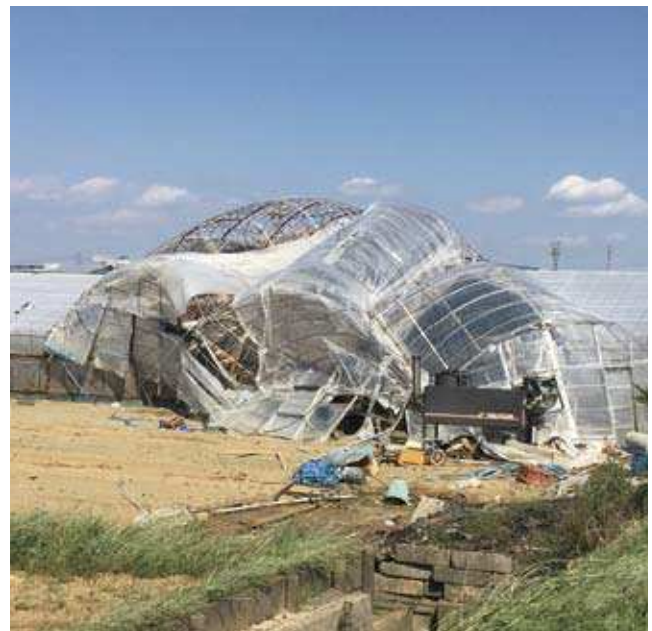
台風で壊れたビニールハウス
